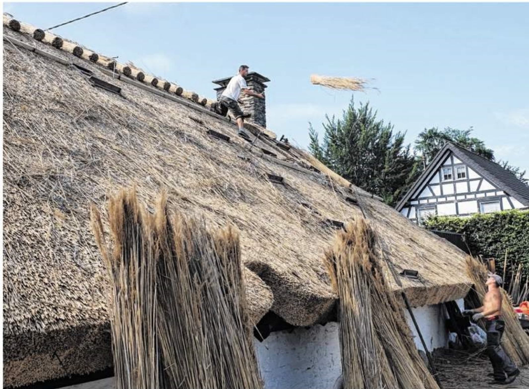
Kommt ein Schilfrohrbündel geflogen: Reetdachdecker aus Ungarn kleiden mit handwerklicher Kunst das „Alte Eifelhaus“ in Höfen komplett mit neuem Reet ein. Foto: P. Stollenwerk
